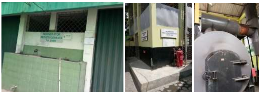
Gambar 3-23 Insinerator 2006 dan Insinerator 2015
