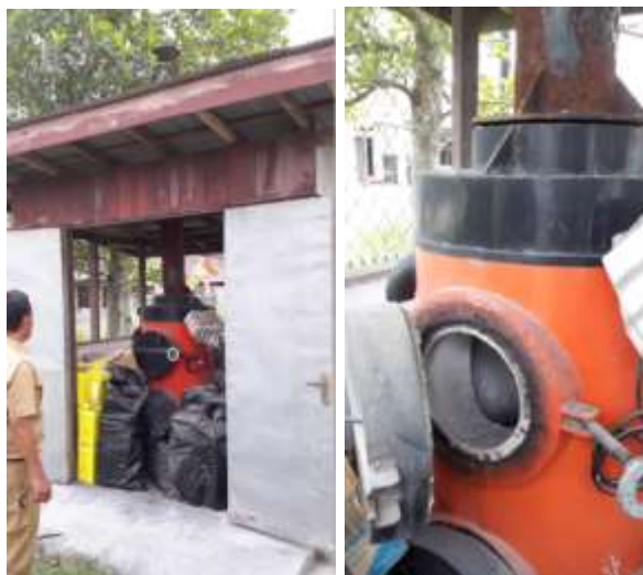
Gambar 3-9 Penumpukan Limbah B3 dan Insinerator yang tidak Beroperasi
